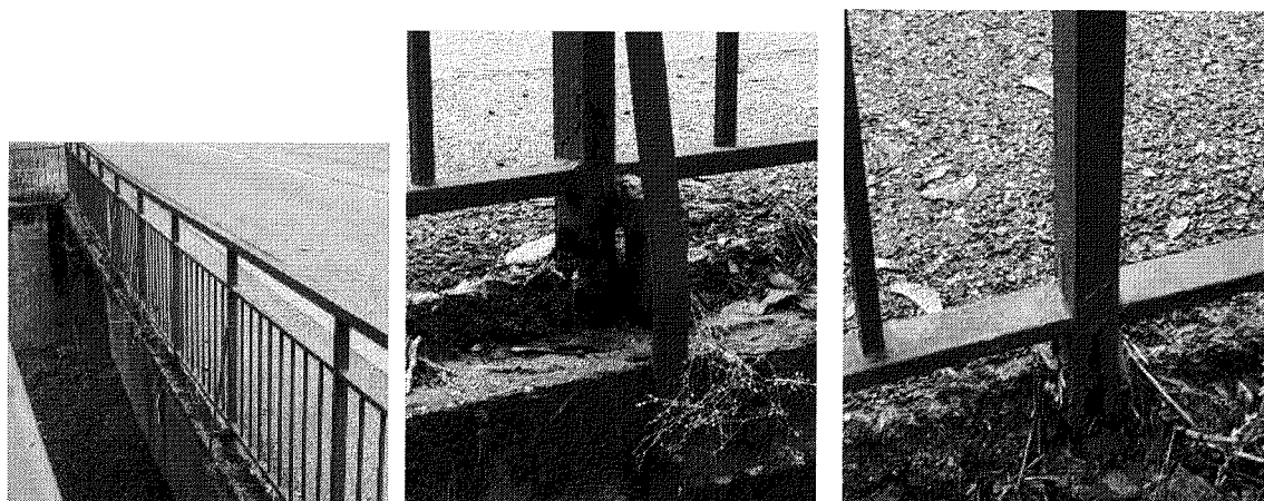
Pieds métalliques de fixation du garde-corps complètement corrodés
